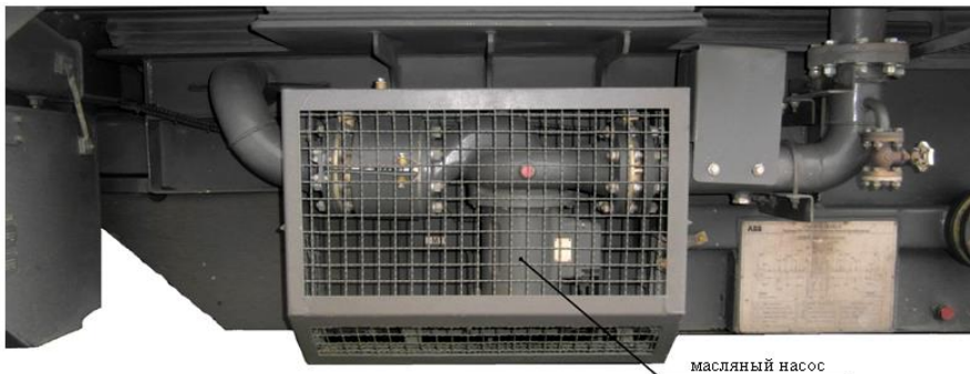
Рисунок 4.5 – Место установки масляного насоса на тяговом трансформаторе
