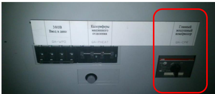
Рисунок 19.8 – Расположение автомата «Главный воздушный компрессор QA-CPR» на шкафу низковольтной аппаратуры
