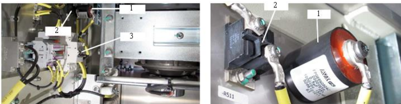
Рисунок 6.34 – Общий вид конденсатора и резистора системы защиты от короткого замыкания на землю:
