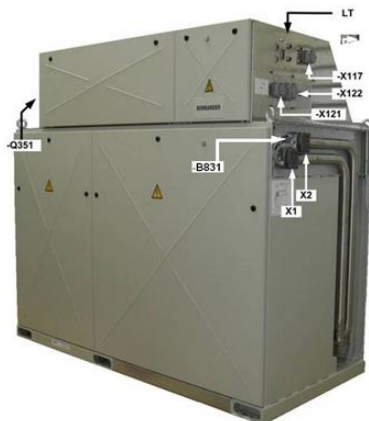
Рисунок 6.13 – Общий вид блока тягового преобразователя, закрытый щитами (вид спереди):
